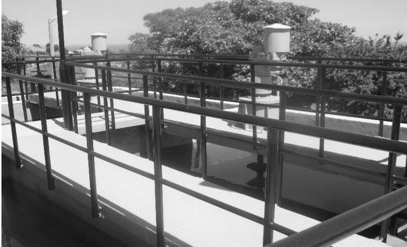
Şekil 12. Barbaros İçme Suyu Arıtma Tesisi (6.220 m 3 /gün) (Fiziksel ve Kimyasal Arıtma + Dezenfeksiyon Üniteleri)
