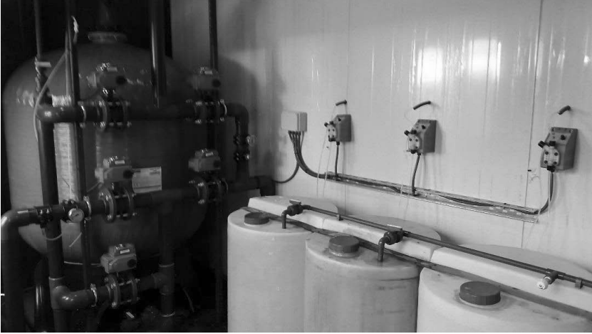
Şekil 5. Hasköy Arsenik Arıtma Sistemi, Aralık 2016
