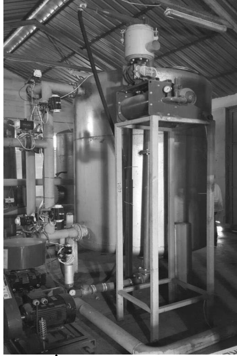
Şekil 4. Yeniçiftlik İçme Suyu Arıtma Tesisi (1.500 m 3 /gün) (Paket Arıtma Sistemi)
