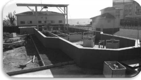
Şekil 9. Süleymanpaşa Derin Deniz Deşarjı Tesisi
