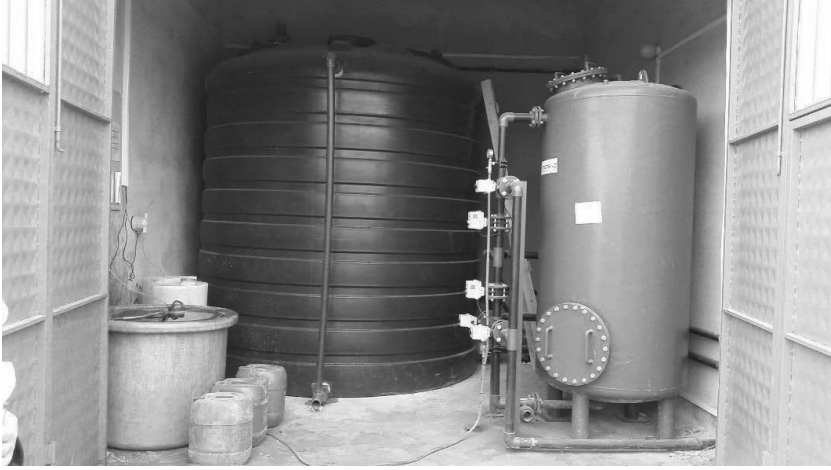
Şekil 4. Dambaslar Arsenik Arıtma Sistemi, Aralık 2016
